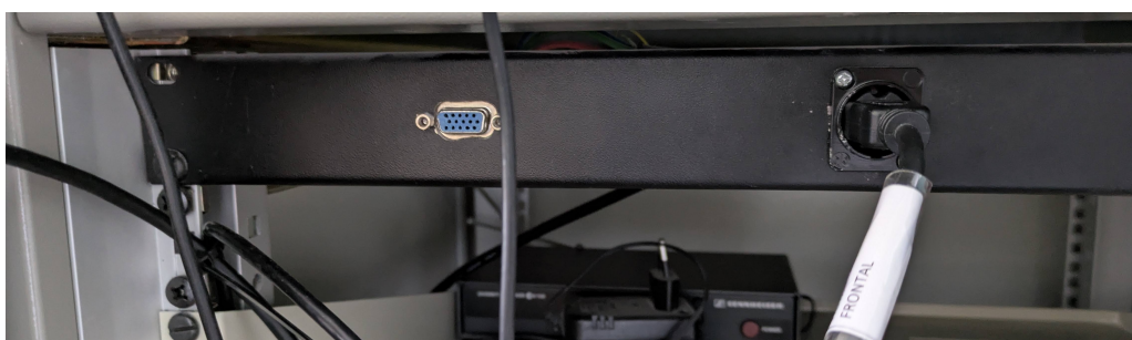
Figura 7: Rack en el edificio Betancourt.
